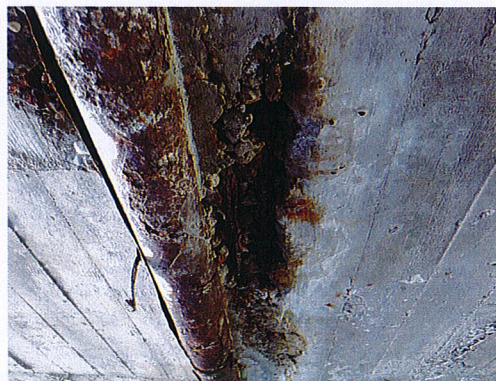
Affioramento armatura giunzione soletta-marciapiede
